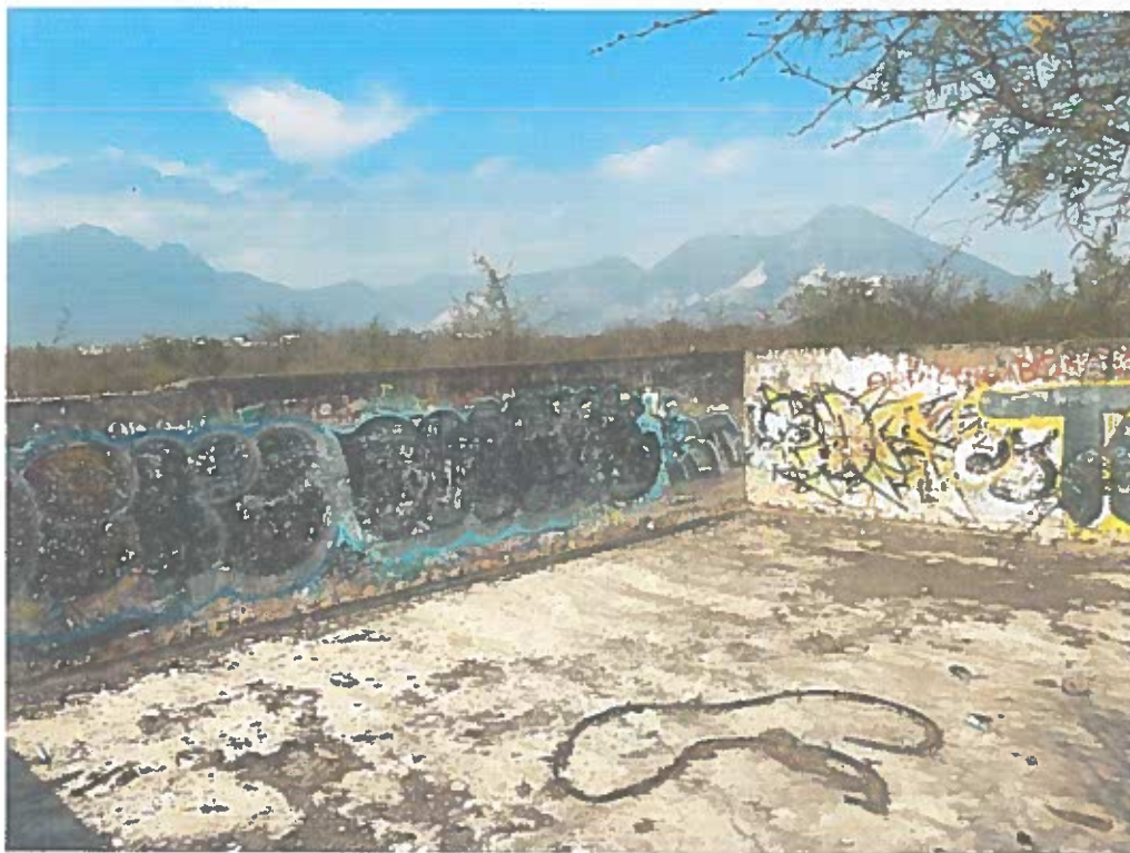
Fotografía No. 9 y 10.- En el sitio existe infraestructura abandonada, que servía para el almacenamiento de agua que se utilizaba para el ganado, como son piletas, noria y abrevaderos.
